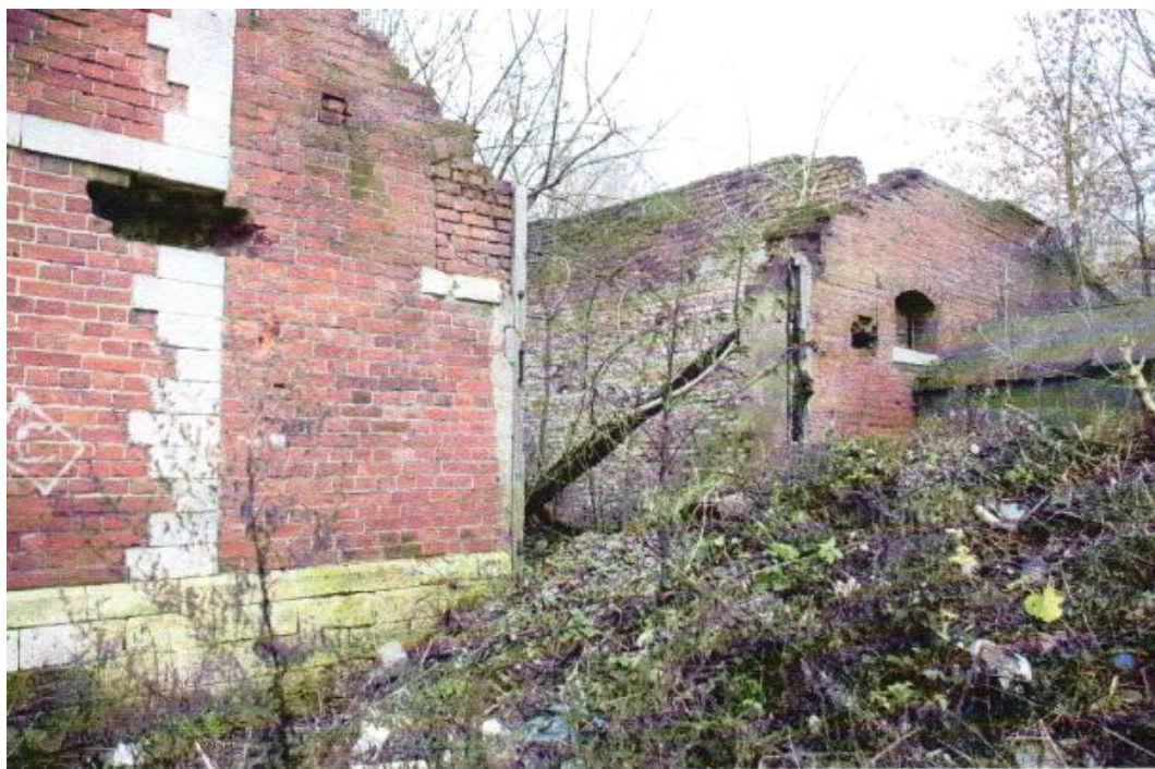
Фотографическое отображение ОКН «Усадьба Кузнецова, конный двор, начало XX в. (Московская область, городской округ Долгопрудный, город Долгопрудный, улица Водники, дом 15) Фрагмент северо-западного фасада здания конного двора.
